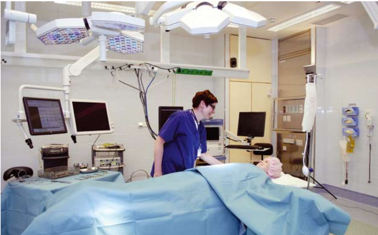
Yksi Savonlinnan keskussairaalan huippumoderneista leikkaussaleista. Uutena leikkaussaleissa on kattopalkisto, jota pitkin kulkee sähkö, data ja kaasut.
